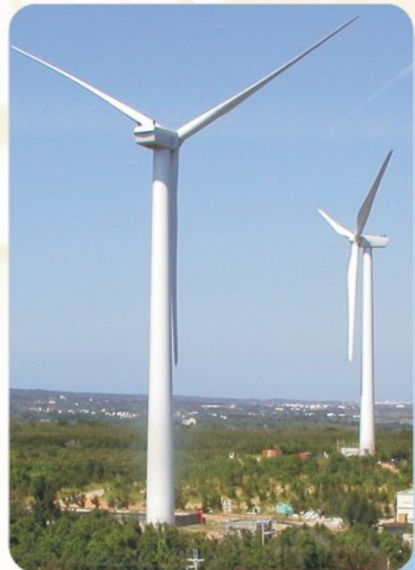
台電核三廠風力發電機組，塔架為中鋼機械公司製造
