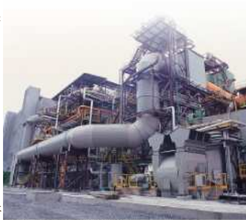
▲動力工場復電機組擴充設備
