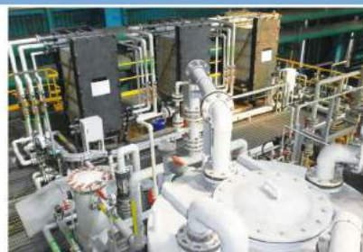
電鍍鋅線廢水回收系統
