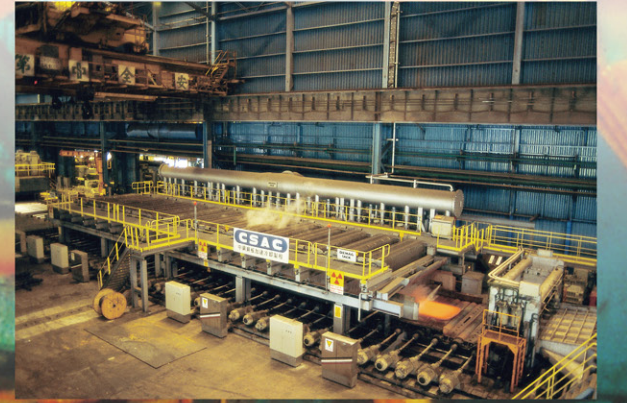
CSAC 加速冷卻設備
