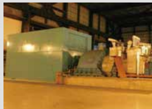
一階動力工場汽輪發電機
