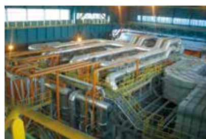
中鋼新線材工場加熱爐
