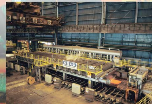
CSAC 加速冷卻設備
