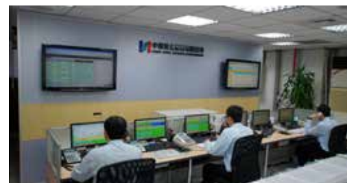
系統保全 24 小時管制中心
