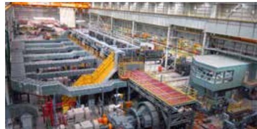
機電設備安裝與維護
