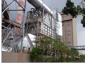
四號燒結廢熱回收
