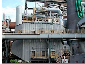
高爐熱風爐廢熱回收
