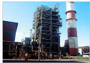
燒結工場脫硝系統
