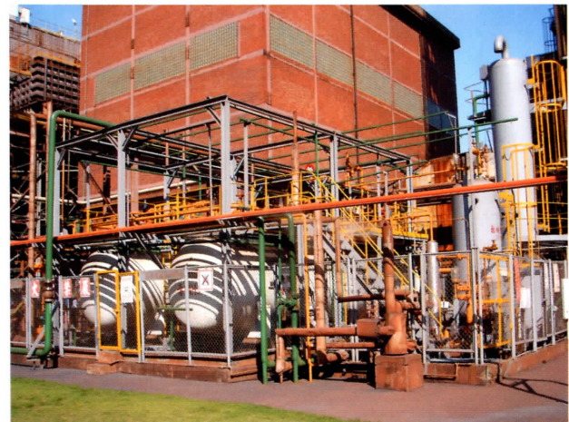
脫硝系統氨槽
