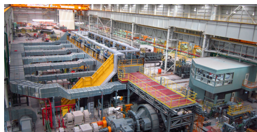
機電設備安裝與維護
