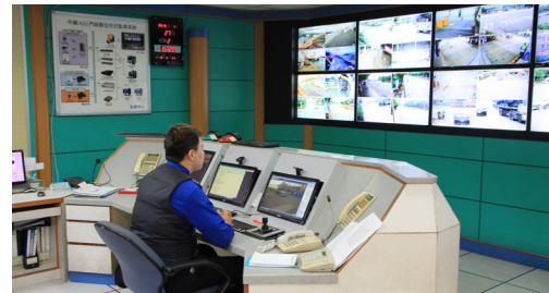
駐衛安全管制中心
